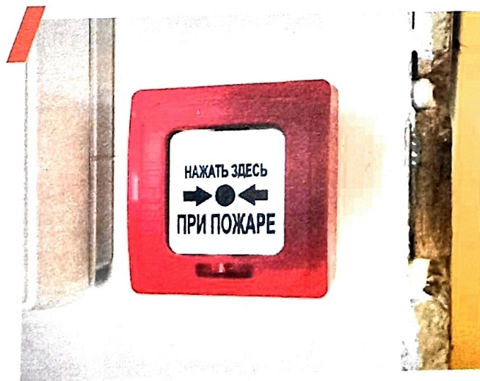
Кнопка пожарной сигнализации для самостоятельного включения
